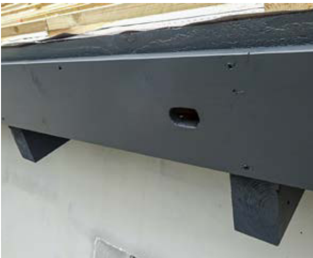
Neu geschaffener Nistplatz für Mauersegler und Haussperling in der Traufe. Das Einflugloch befindet sich im Stirnbrett, der Brutraum liegt geschützt dahinter.
